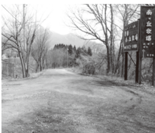
改良が必要とされる道路
