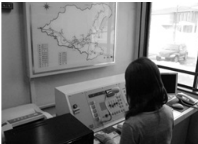
防災無線放送設備
