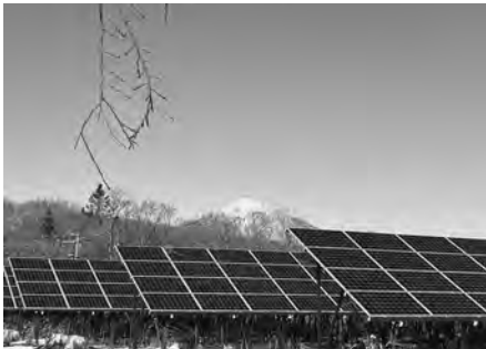
設置されたメガソーラー
