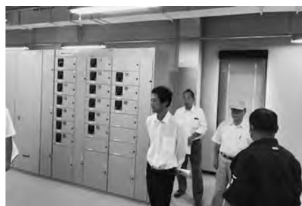
施設内の機械の確認
