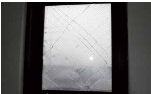
地震で破損した役場庁舎塔屋のガラス
