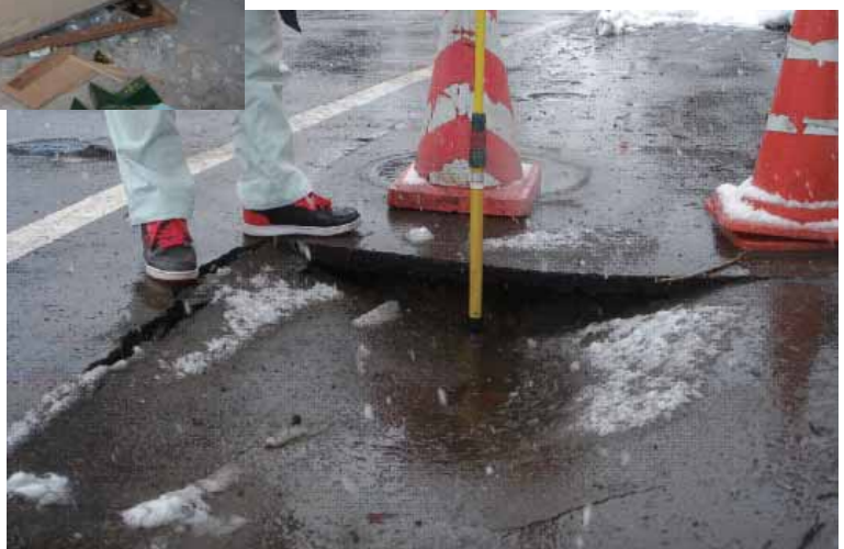
地震で陥没した道路
