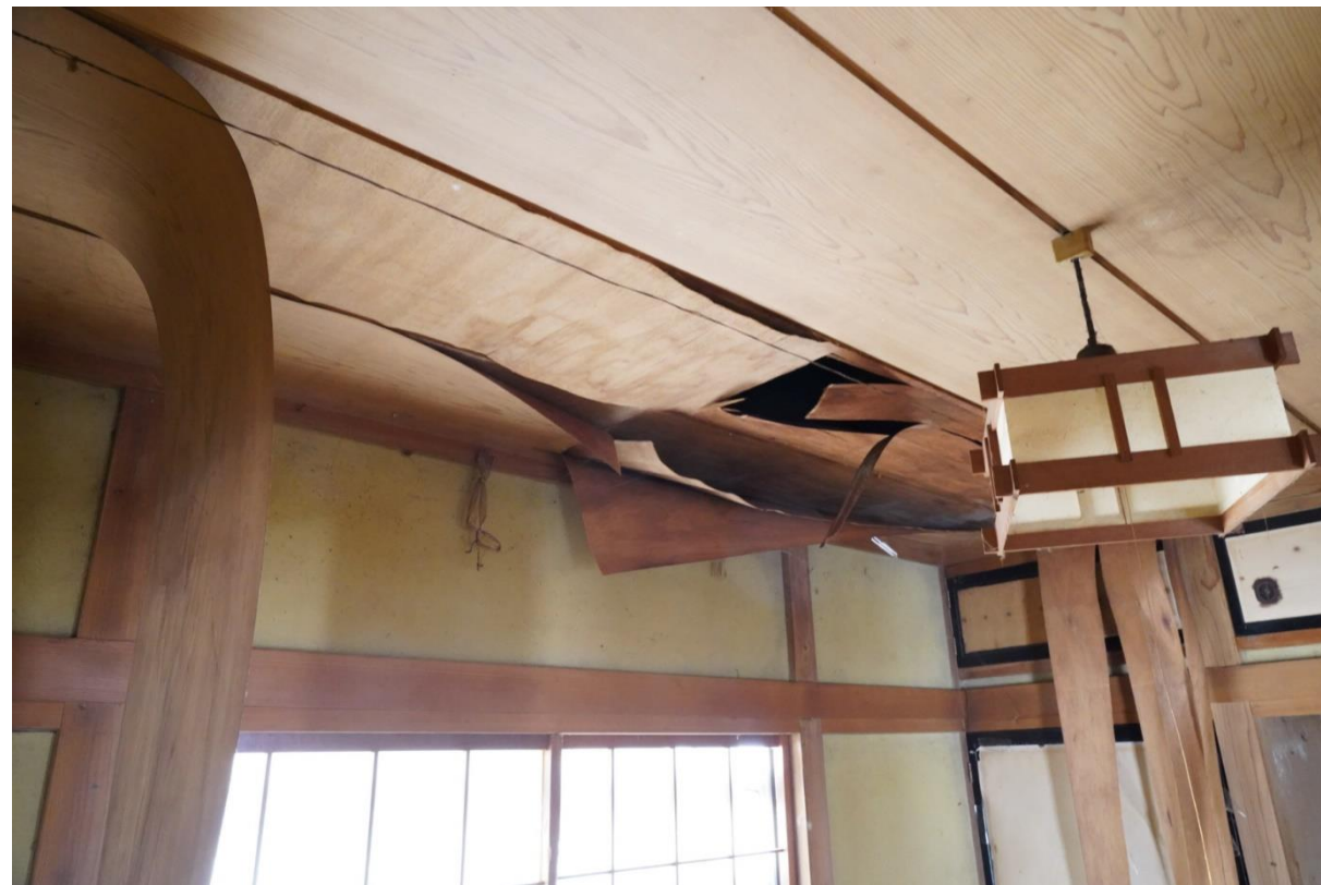
一階 和室③ 修繕必要箇所
