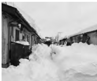
老朽化が進む町営住宅
