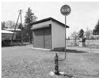
管理を委託している消防施設
