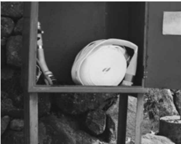
町内全域に171本整備した防火栓ホース
