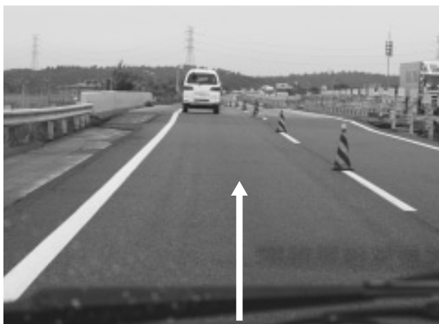
車窓から見た北陸自動車道（写真中央がゆがんでいる）
