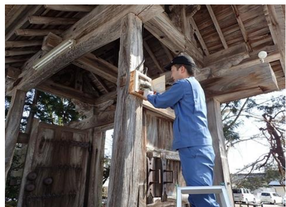
文化財建造物自動火災報知機設備点検 (恵日寺山門)
